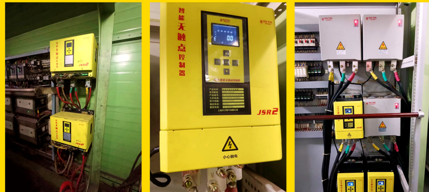
某钢厂转子回路无触点应用，产品体积小，方便升级换代
