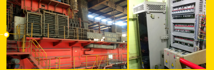
江西新余钢铁 4 台 360T 铸造吊 主钩电机 500KW×2 QY2-2000S/T5 525V 一拖二驱动
