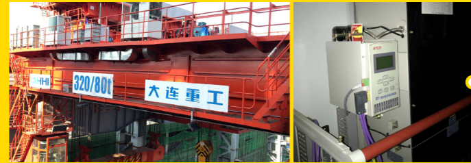
津西钢铁 5 台 320T 铸造吊 主钩电机 400KW×2 QY3-1000S-A-FL 690V 一拖二驱动 具备再启动防溜钩装置
