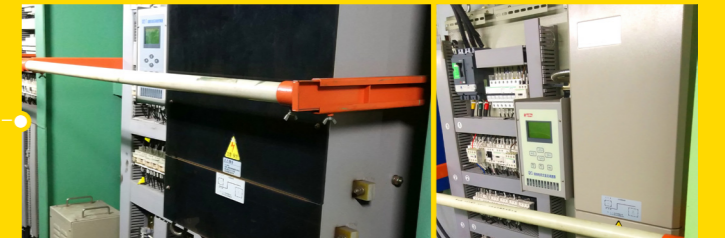
宝钢条钢事业部 15 台桥吊 全机构采用 QY3A 系列，转子采用 JSR1 电机无触点控制器。
