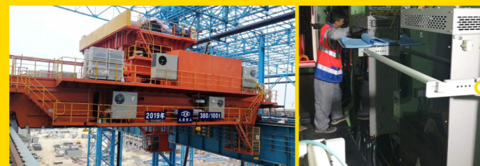
广西防城港钢铁 11 台 380T 及 400T 铸造吊 主钩电机 620KW×2 QY3-2000S-A 690V 一拖二驱动
